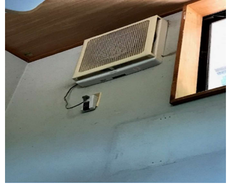
29、【館内】換気扇の常時館内換気
